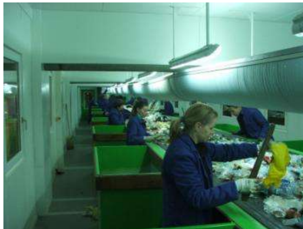
Slika 25. Kabina separacione trake
